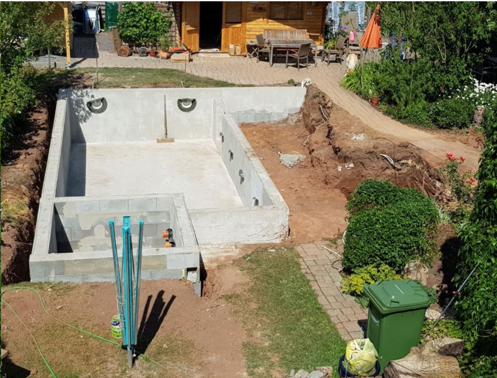
▲ Zwei Wochen nach Baubeginn ist am Baufortschritt bereits gut zu erkennen, wo die Reise hingehen soll.
