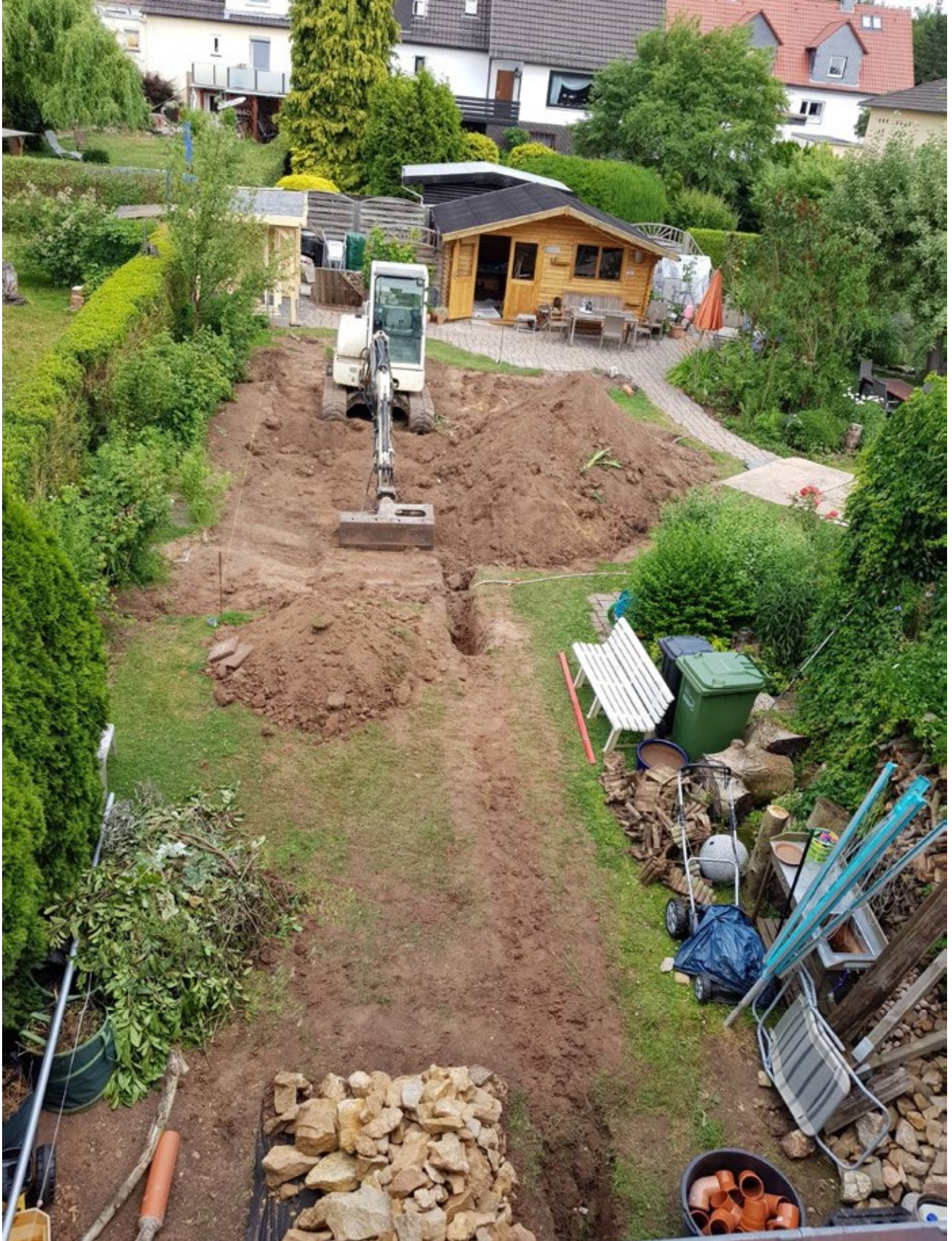
▲ Sind Beratungen und Planungen abgeschlossen beginnt die »heiße Phase« mit den Erdbewegungen. Der Garten bekommt seine neue Gestalt.
